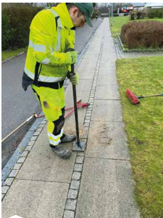
OKNygaards undersøgelser af et fortov ved Horsebred viste, at der under belægningen kun er 16-24 cm. afretningslag med 0-8 mm bakkegrus.
