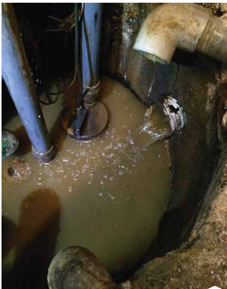
Drænudløb til brønd under bygning.
