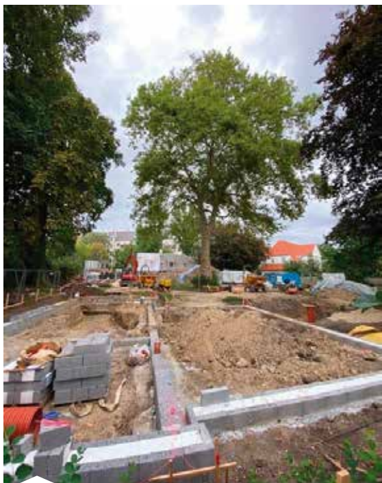
Et klassisk eksempel på manglende beskyttelse af træer under byggeri.
